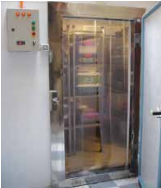
Foto 16: Cámara de almacenamiento en frío.
